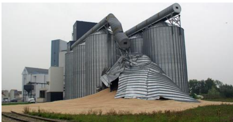
Photo 13 : Vue d'une cellule effondrée à Anglure
