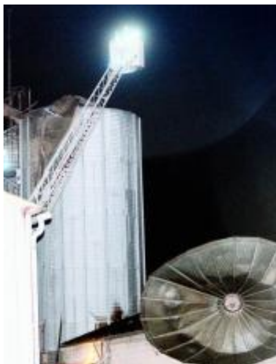
Photo 15 : Vue du toit après explosion à Dormans
