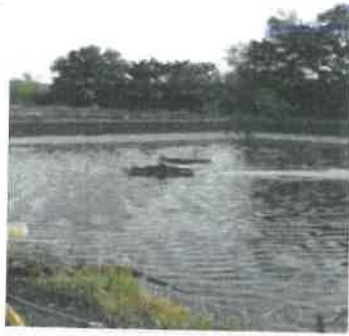
Pompe brassage bassin lixivié (non fonctionnelle lors des mesures)
