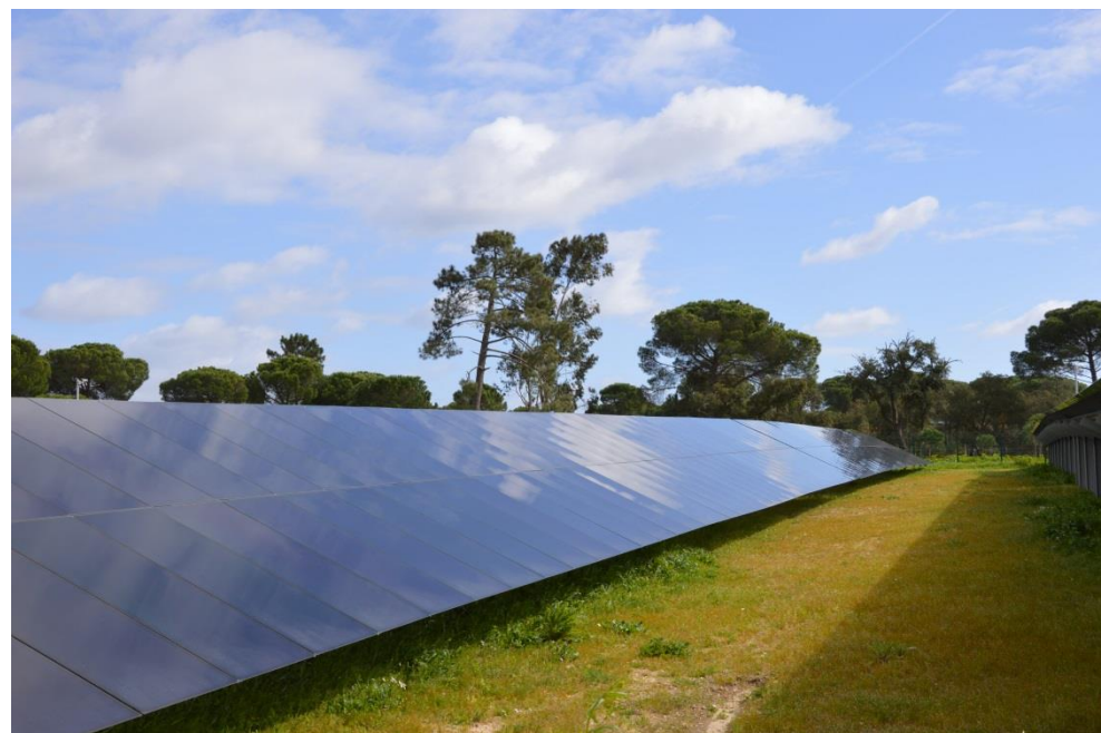
Illustration 12 : Exemple d'une rangée de modules
