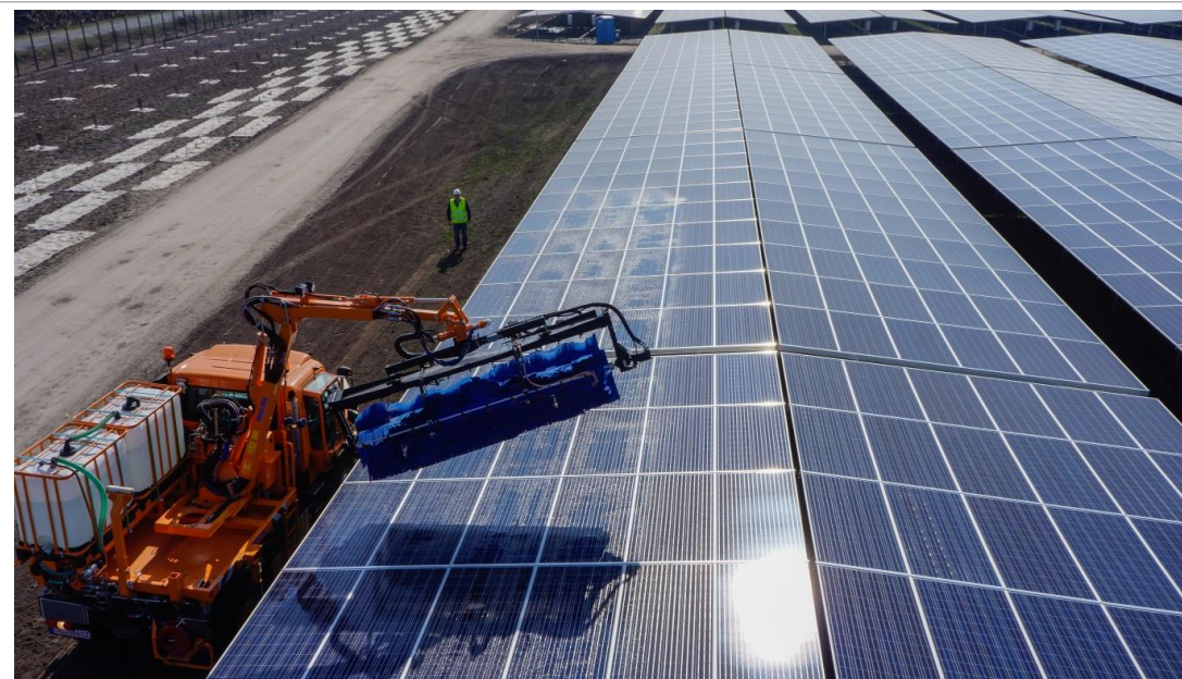
Illustration 23 : Exemple de procédé de nettoyage des modules
