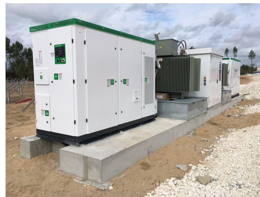
Illustration 13 : Exemple de poste de conversion « outdoor » Source : Schneider
