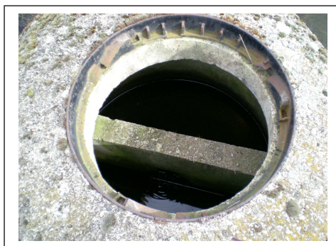
Séparateur hydrocarbure (APRR)
