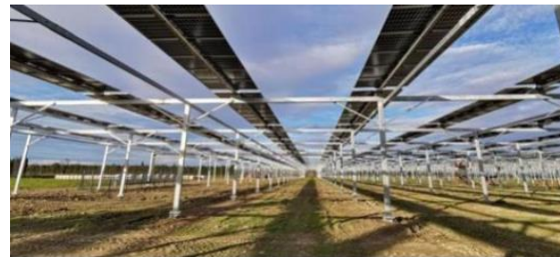
Figures 65 : Ombrières trackers dynamiques (Source : TotalEnergies)
