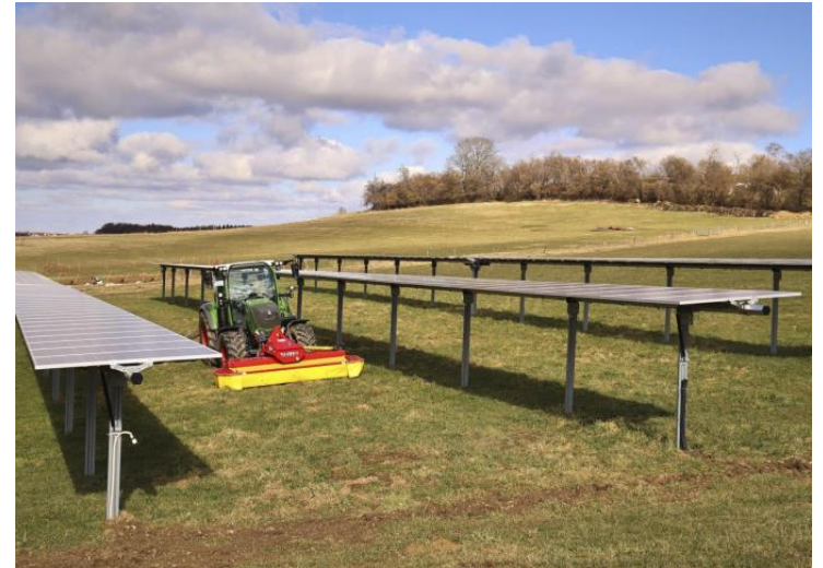
Figures 67 : Panneaux trackers à 90° (Source : TotalEnergies)
