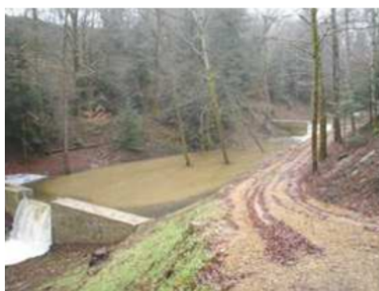
Bassin de décantation en fonctionnement lors d'une vidange
