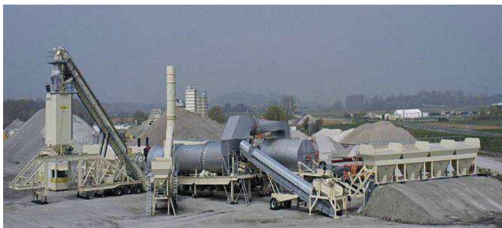
Illustration n° 7 : Photographie d'une centrale d'enrobage de type RF500
